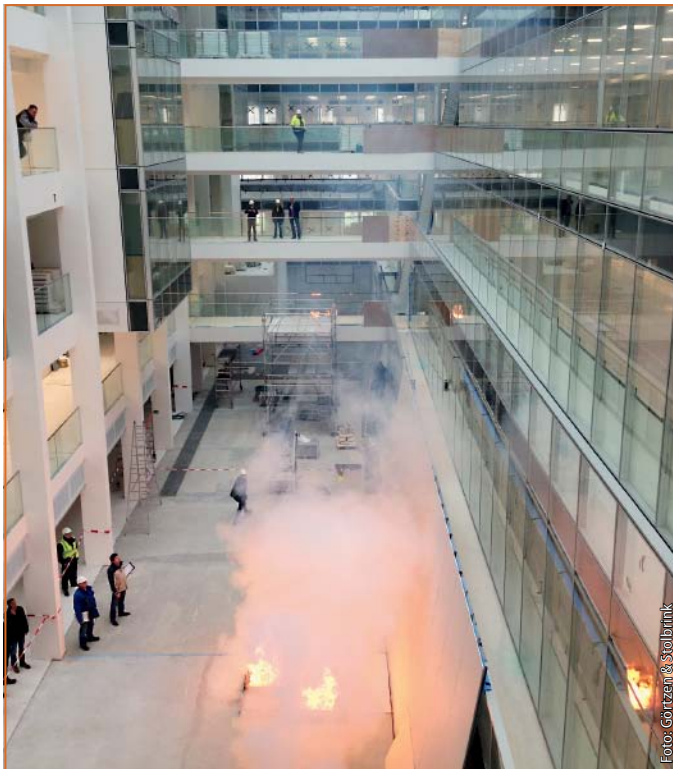
Abb. 3: Zur Inbetriebnahme bestätigten Rauchversuche mit Wärmequellen von bis zu 1,5 MW die Planung der Entrauchungsanlage in der Magistrale. Die erforderliche Zuluft für die Entrauchung wird mechanisch und natürlich über Fassadenlamellen der Magistrale zugeführt. Die Rauchabführung erfolgt über Entrauchungskanäle an den Längsseiten der Magistrale, jeweils konzentriert über dem Brandort.
