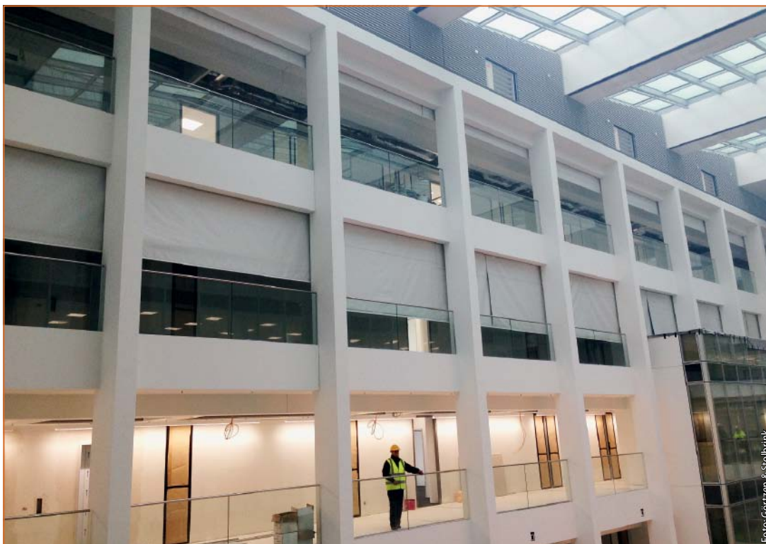
Abb. 4: Die Galerien in den beiden oberen Etagen werden im Brandfall durch Rauchschürzen von der Magistrale abgetrennt, da hier eine ausreichende Rauchfreiheit nicht mehr nachgewiesen werden konnte. Oberhalb der Galerien sind die Öffnungen zu einem der beiden Entrauchungskanäle zu erkennen, die durch die Brandmeldeanlage je nach Brandentstehungsort selektiv angesteuert werden.
